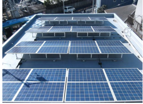
写真2 太陽光パネル②
